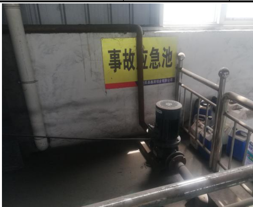
图 4.1.7 应急事故池照片
