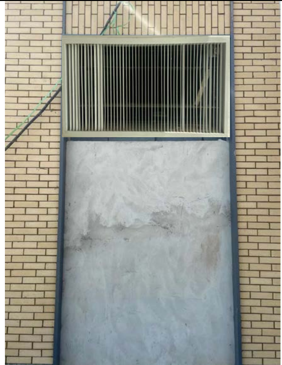
地下车库通风排放口
