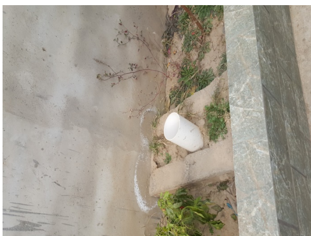
化粪池吸粪口
