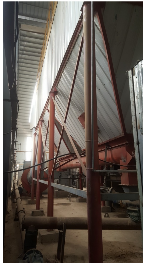
烘干工序 2 号除尘器
