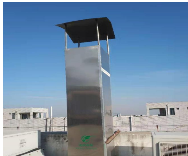
项目废气处理措施排气口
